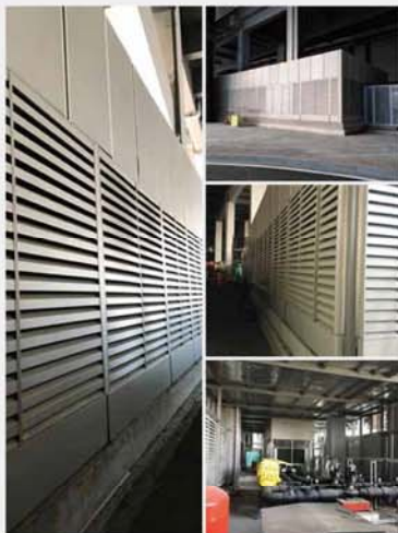
热泵机组降噪
